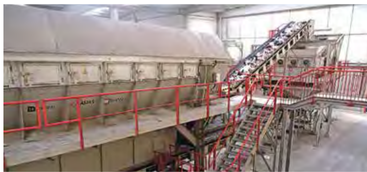
GESTIÓ. Instal·lacions del Centre de Tractament de Residus (CTR) comarcal
