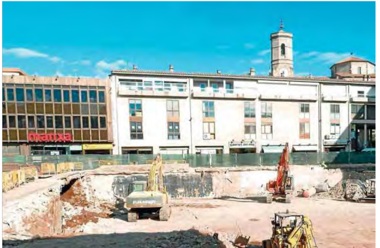
L'empresa constructora està perforant el terreny per construir les plantes subterrànies de la nova plaça Mercat ■ J.C.
