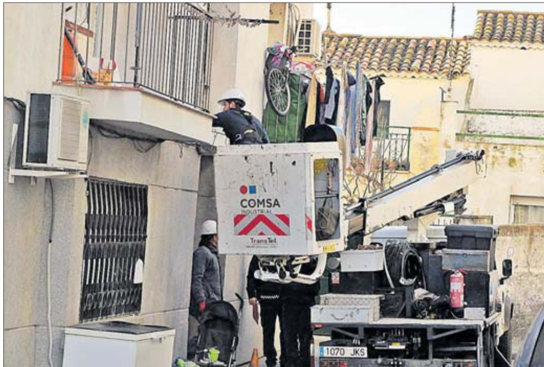
Tècnics d'Endesa en un dels operatius contra el frau elèctric a la zona oest. DIARI DE GIRONA
