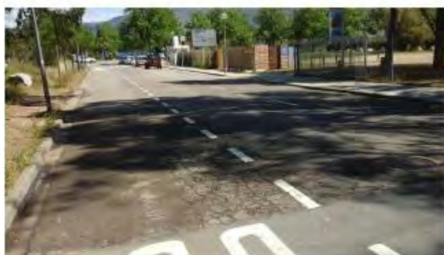
Un carrer deteriorat a Roses EMPORDA.INFO
