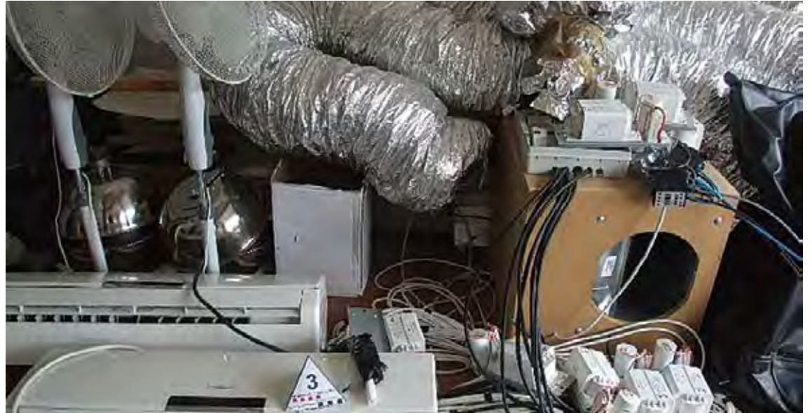
EL MATERIAL. Ventiladors, centrifugadors, làmpades, transformadors, quadres elèctrics i també una pistola detonadora
