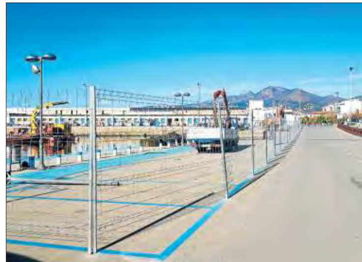
El port pesquer de Roses on s'han iniciat les obres. PORTS DE LA GENERALITAT
