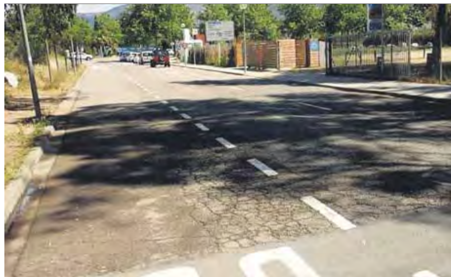
Un dels carrers que seran reasfaltats i que està molt deteriorat ■ AJ. ROSES
