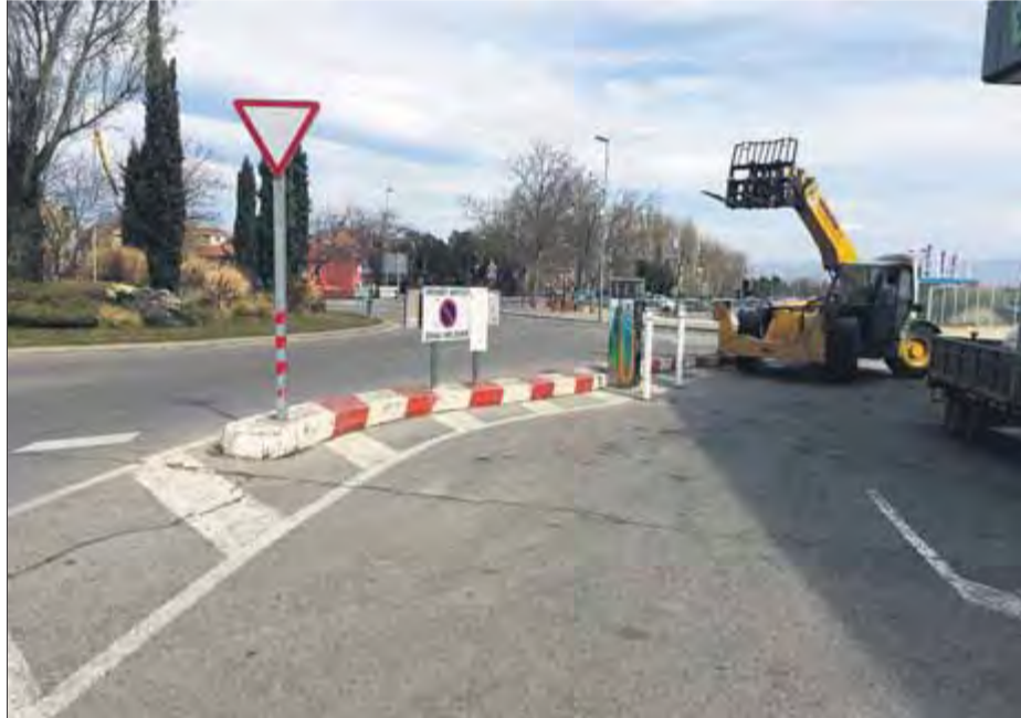
La zona on es construirà la vorera per a vianants ■ JOAN PUNTÍ
