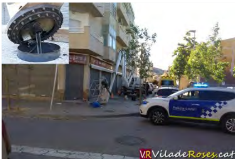
La plataforma caiguda a terra i en la foto detall la base del braç elevador desenganxada
