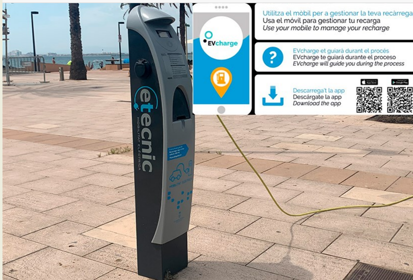
Punt de càrrega de vehicles elèctric a la plaça de Les Botxes de Roses , a l'Avda de Rhode
