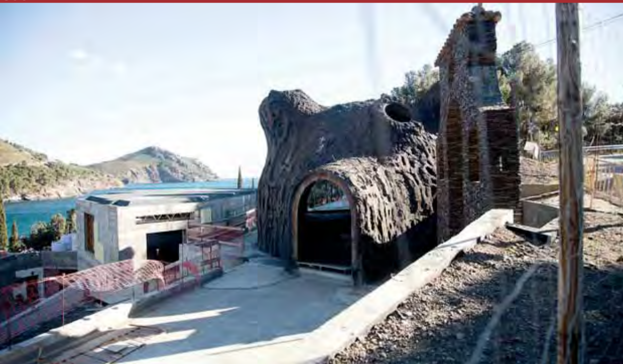
Estat de les obres del projecte del cuiner Ferran Adrià, a la cala Montjoi de Roses ■ QUIM PUIG
