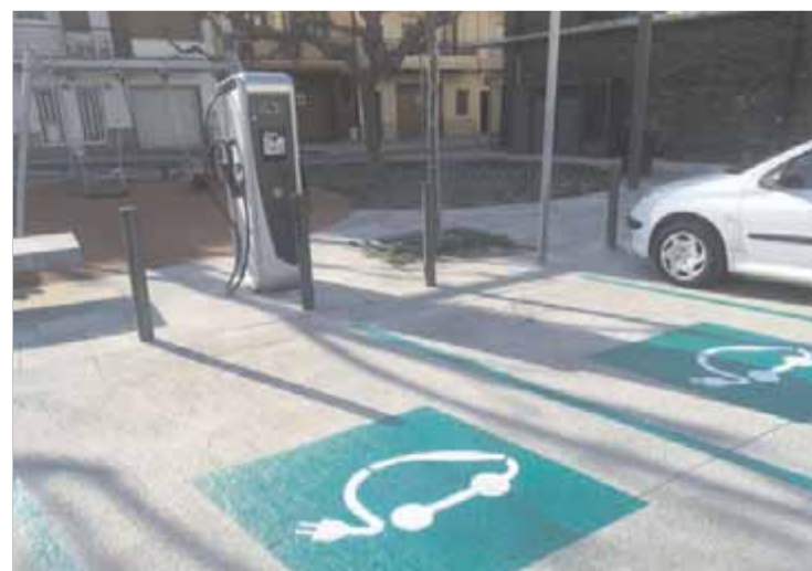
Detall dels nous punts de càrrega instal·lats a Roses ■ REDACCIÓ
