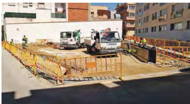
MATERIALS. L'interior de la placeta serà de grava i sauló compactat. AJ. DE ROSES
