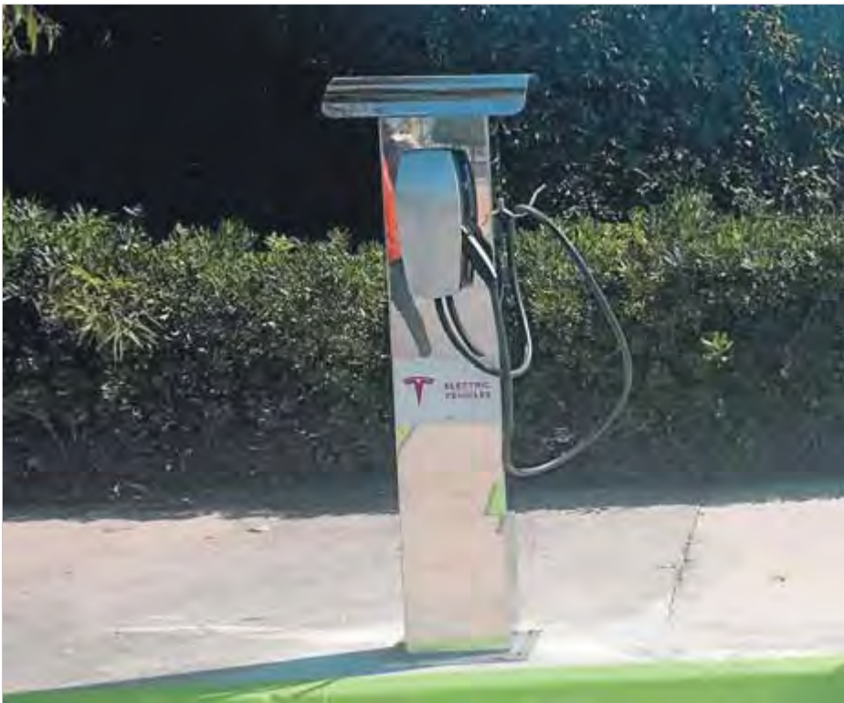
Un punt de recàrrega com els que s'instal·laran en diversos ports de la demarcació de Girona ■ PORTS DE LA GENERALITAT
