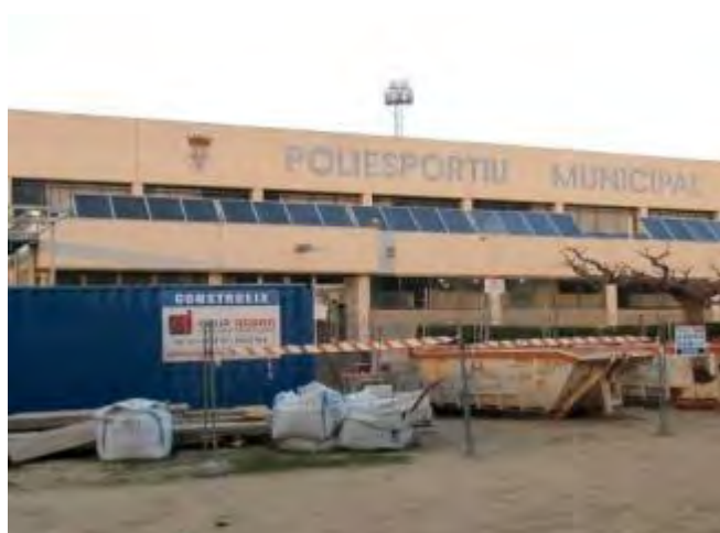
L'adjudicatària de les obres del pavelló poliesportiu de Roses fa fallida Gerad Blanché
