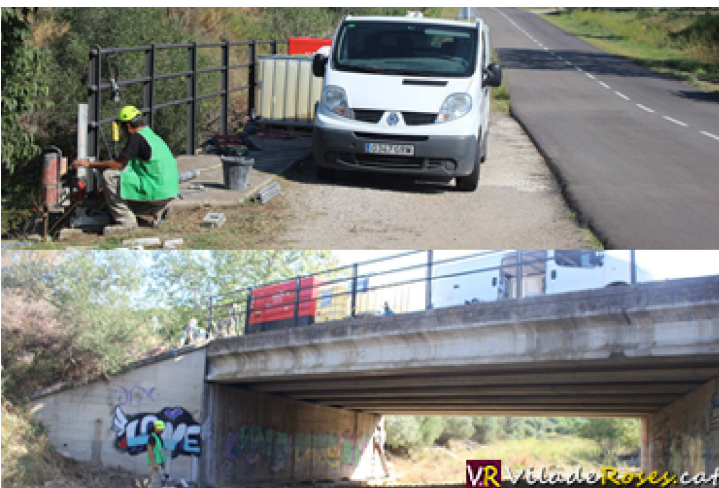
Obres al pont de la carretera de les Arenes, a tocar a Mas Palou
