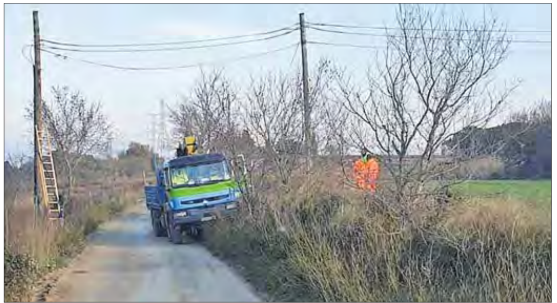
Els operaris, reposant el cablejat robat en el robatori del 15 de gener. AJUNTAMENT DE BORRASSÀ
