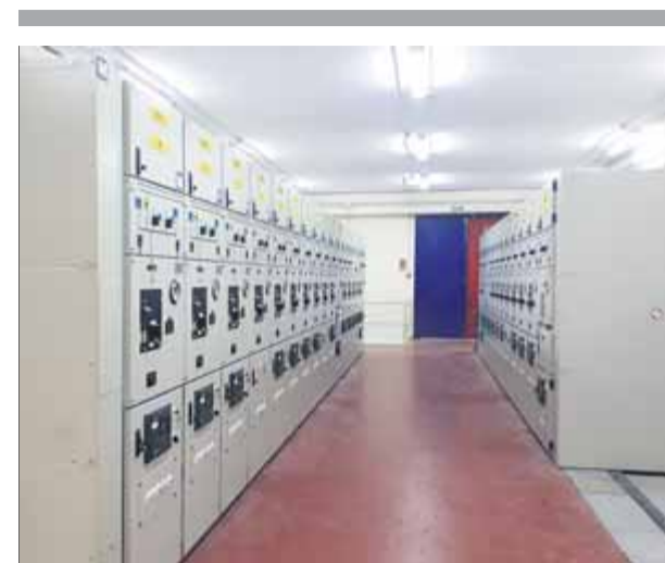
L'interior de l'edifici que s'ha construït en la primera fase de les obres ■ ENDESA
