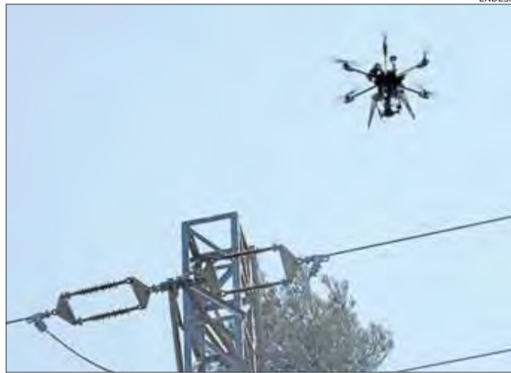
Endesa utilitza drons per comprovar l'estat de la xarxa elèctrica.
