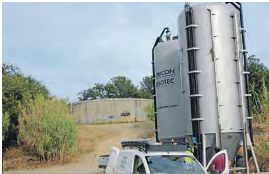
El dipòsit principal del puig de Sant Ramon, en segon terme, i el filtre instal·lat el 2016 ■ E.A.
