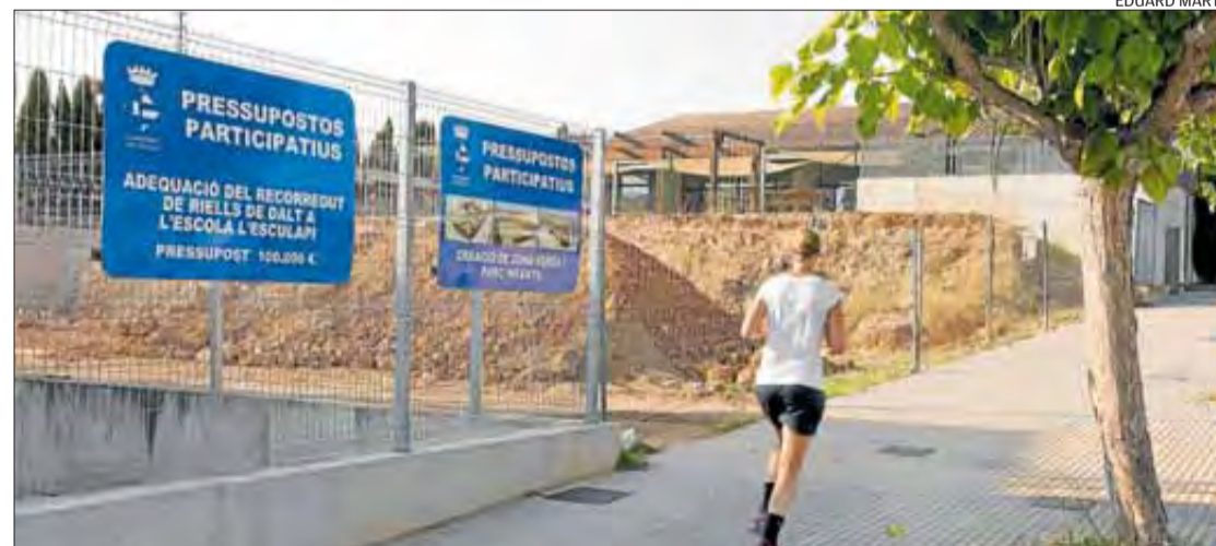
Els operaris i les màquines excavadores ja han començat a treballar en el terreny de la nova zona infantil.
