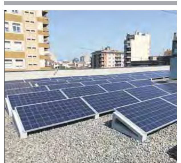
La nova instal·lació, situada a la coberta de l'edifici dels serveis tècnics (OMAC) ■ AJ. FIGUERES
