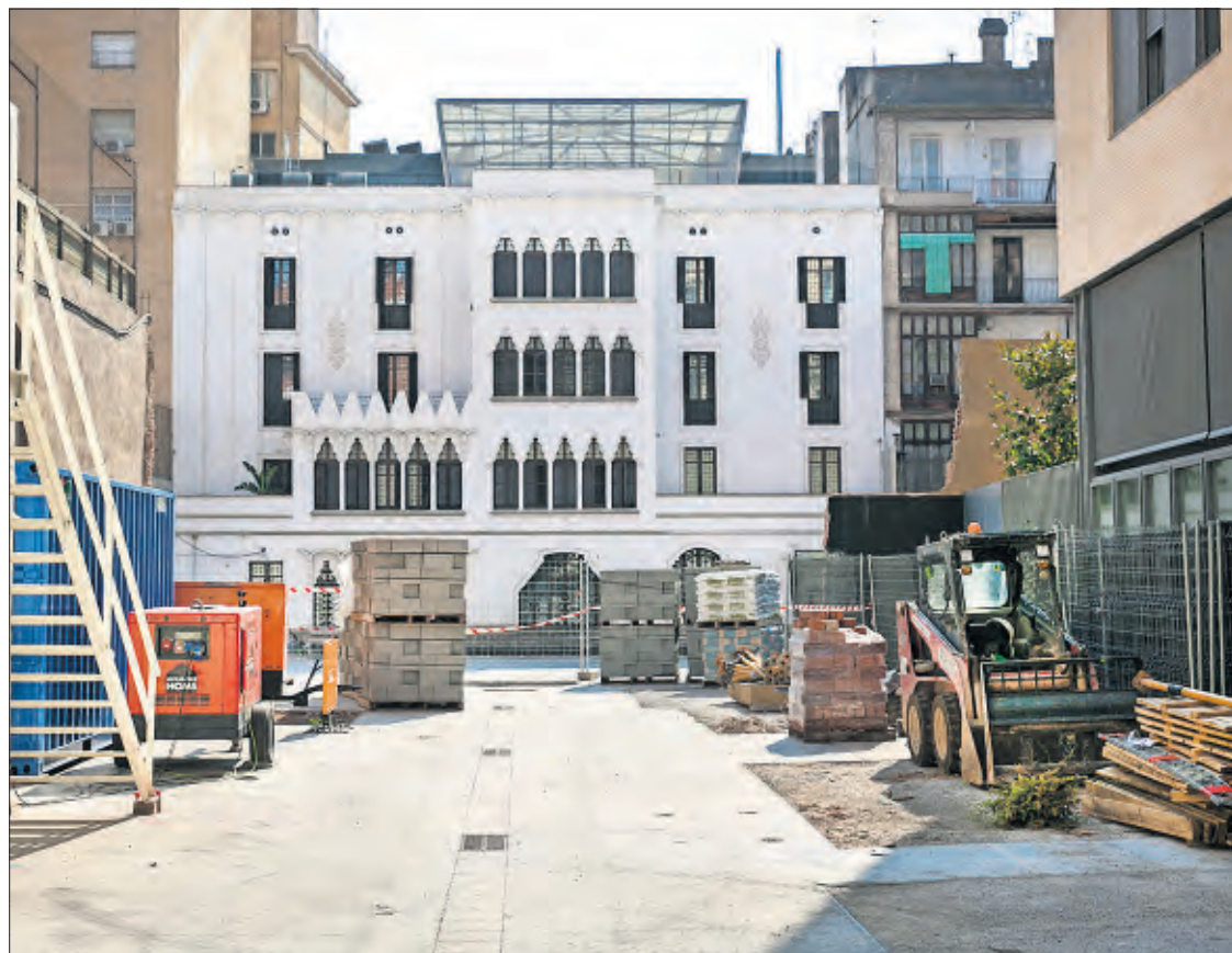
Obras de reforma en el patio interior de la illa Macaya, en el Eixample. / MASSIMILIANO MINOCRI
