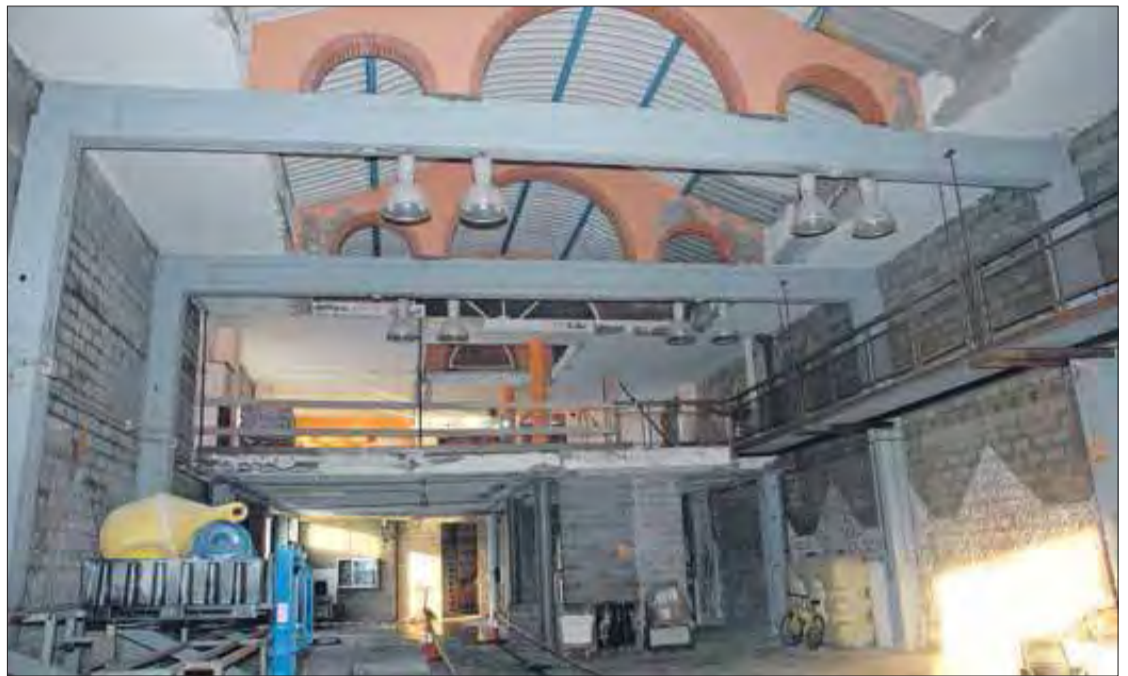
La llotja del port de Llançà es troba en període d'obres de reforma. EMPORDÀ
