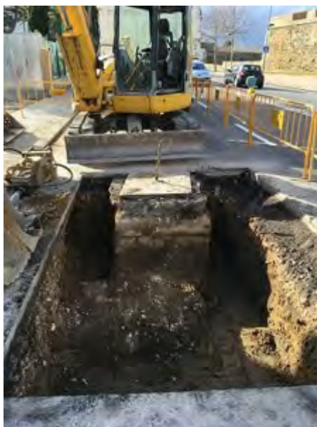
Les obres es porten a terme en el col·lector de la xarxa de sanejament
