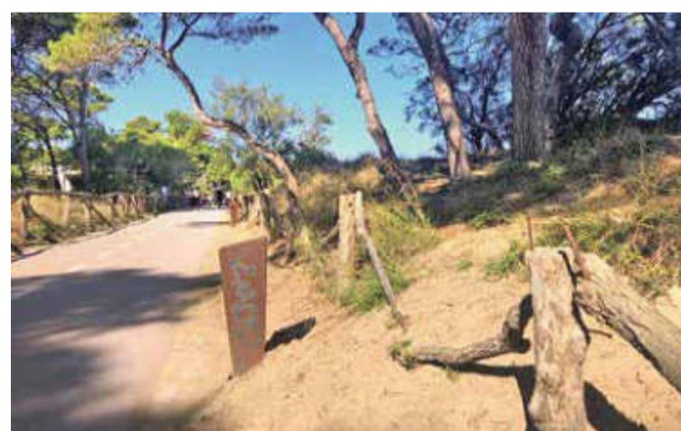
PASSEIG D'EMPÚRIES. Actualment es treballa en la renovació de les tanques M. ARRANZ
