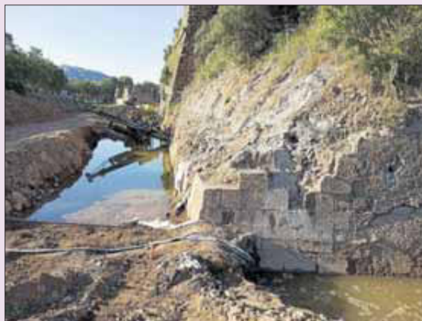
Aquest reg d'aigua permet arribar a la base enterrada.
