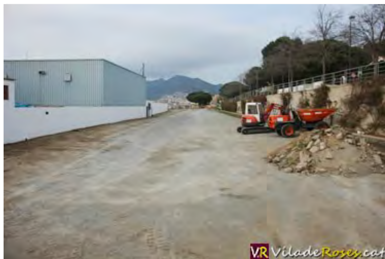
Aquesta és la superfície de 1.900 m2, adjacent a la platja dels Palangrers, que encabirà un pàrquing, una vorera per vianants amb el seu respectiu enjardinament
