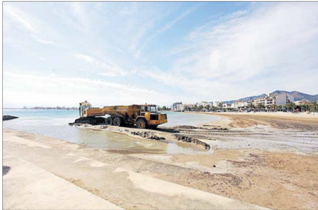
Treballs de reparació de la platja de la Punta. DIARI DE GIRONA
