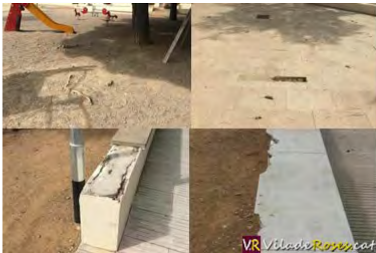
Alguns dels desperfectes que presenta la plaça de l'Alegria de la urbanització de Mas Mates
