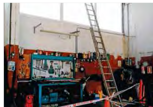
Al parc de bombers de Figueres es va haver d'apuntalar un finestral perquè no aguantava la tramuntanada ■ EPA
