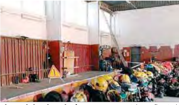
Al parc de bombers de Figueres es va apuntalar un finestral
