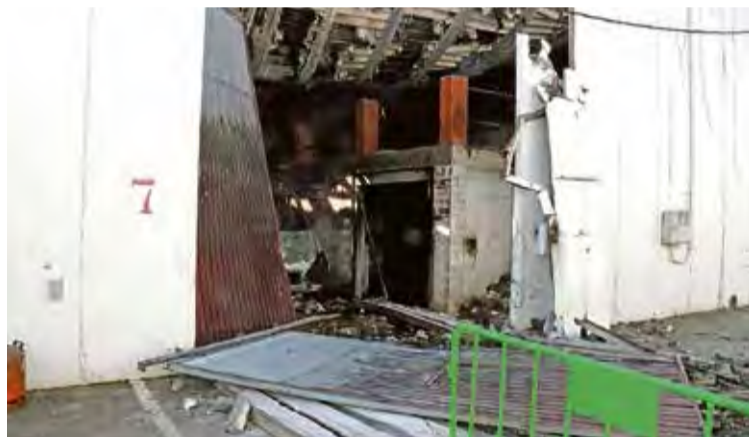
LA NAU. Imatge de com va quedar l'estructura afectada pel foc
