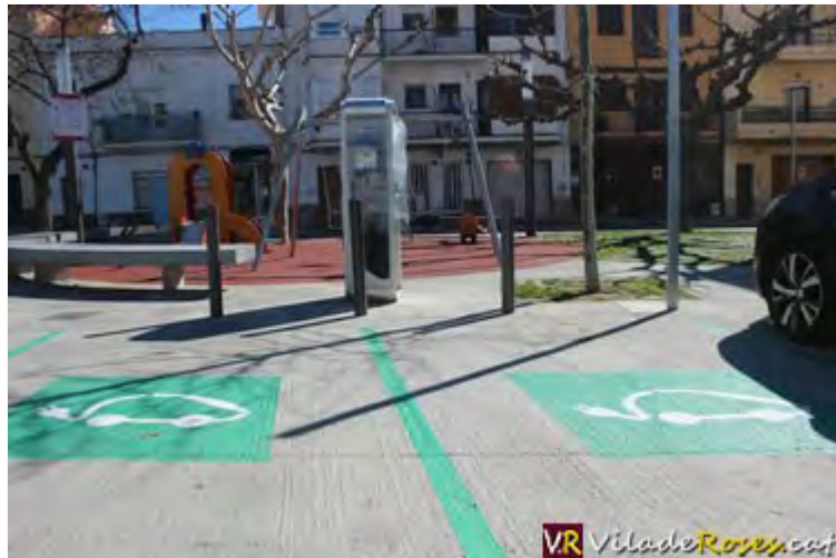
Punt de recàrrega de vehicles elèctrics ubicat a la Rambla Ginjolers
