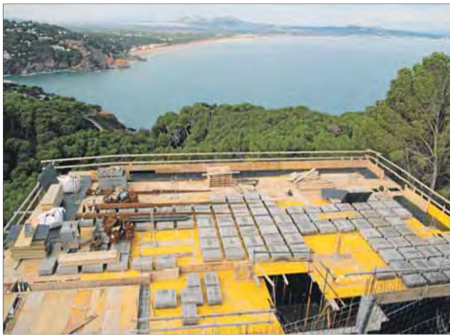
Una de les cases en construcció a la pedrera de s'Antiga, a principis d'any ■ E.A.
