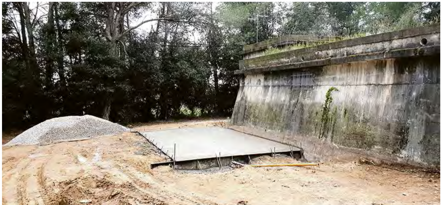
LA PLANTA PER ELIMINAR NITRATS. Ubicada al costat del dipòsit municipal d'aigua i al costat contrari de la carretera C-260
