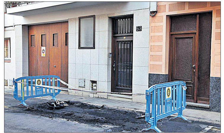
L'estat de la façana arran de l'incendi del vehicle. GERARD BLANCHÉ
