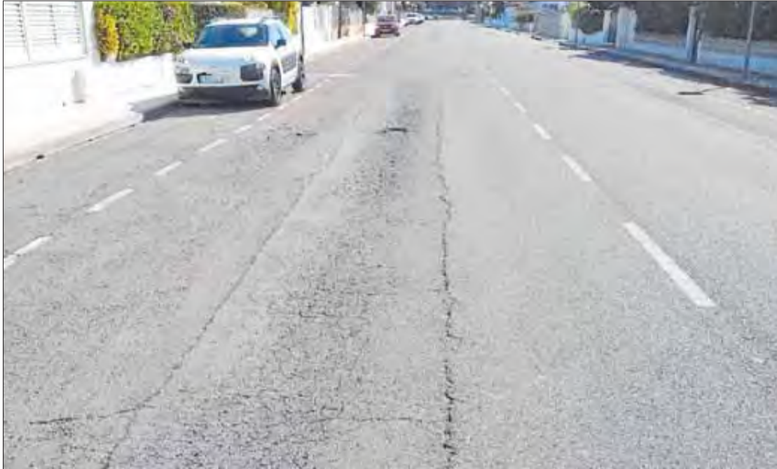
Els carrers sobre els quals s'actua necessiten una intervenció urgent per deteriorament de l'asfalt.
