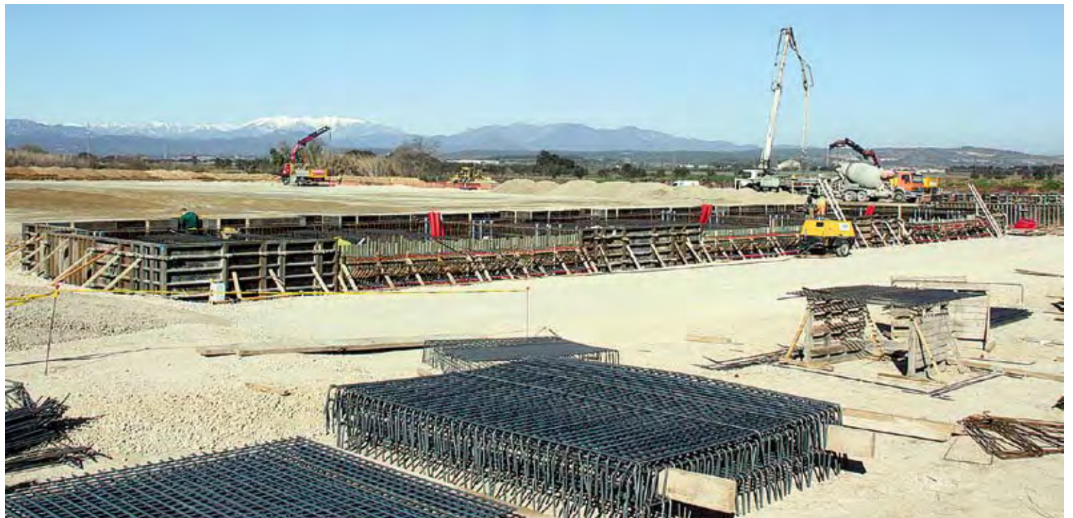
SANTA LLOGAIA D'ÀLGUEMA. Els operaris ja han començat a aplanar el terreny on es construirà l'estació transformadora, que estarà envoltada de quatre subestacions
