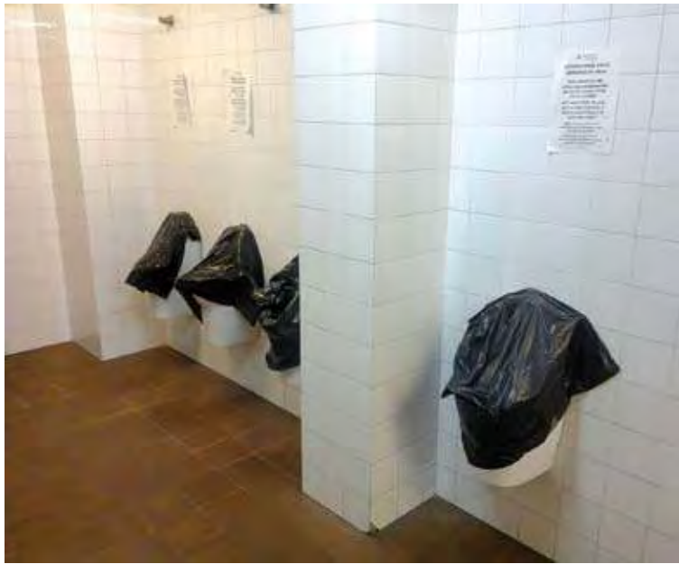
SENSE SERVEIS. Urinaris taptats i amb rètols prohibint-ne l'ús
