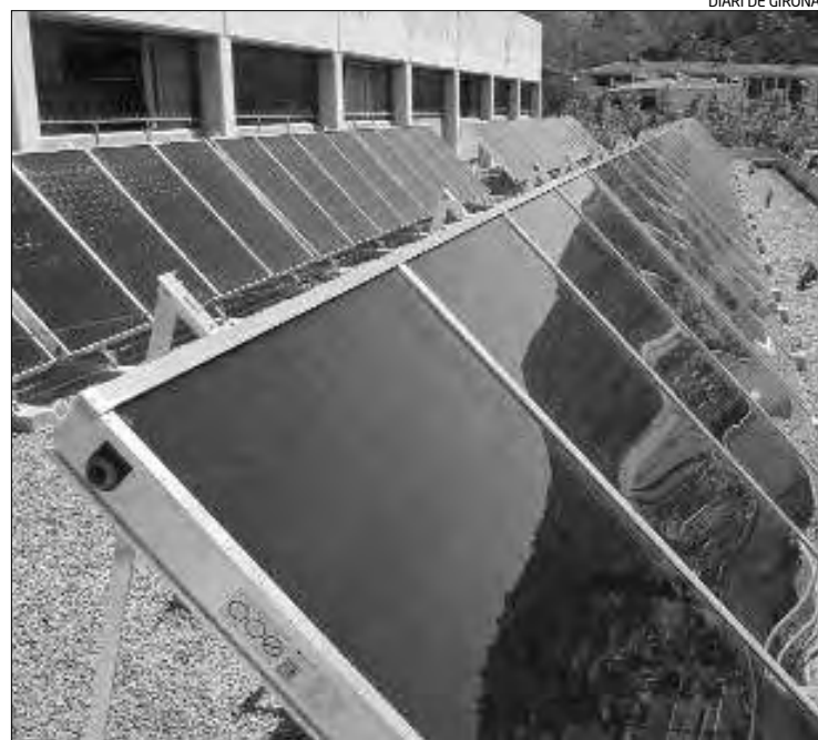
Les plaques solars instal·lades per escalfar l'aigua de la piscina.
