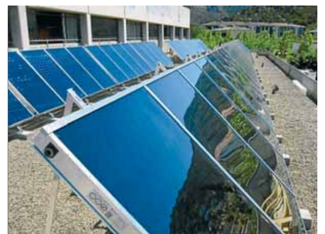
Les plaques solars que s'han instal·lat a la piscina municipal de Roses ■ EL PUNT AVUI
