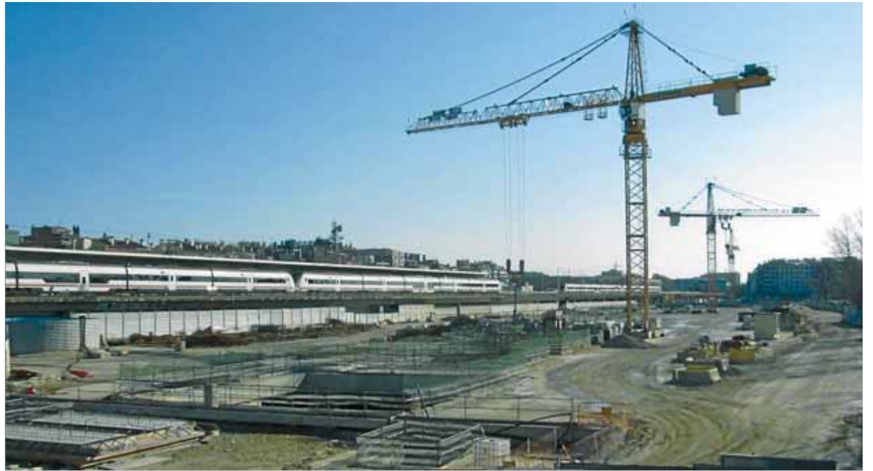
Un tren convencional passa pel viaducte de Girona, en una imatge recent ■ D. VILÀ
