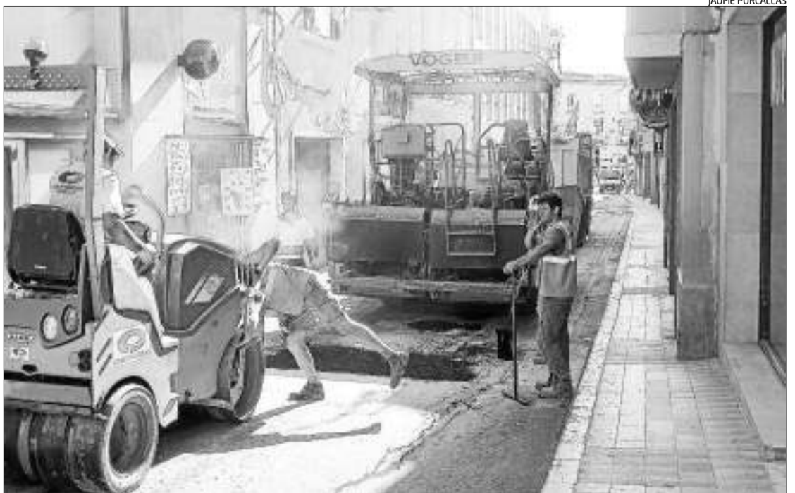
Els operaris treballant en l'actuació a la zona aquest divendres al matí.
