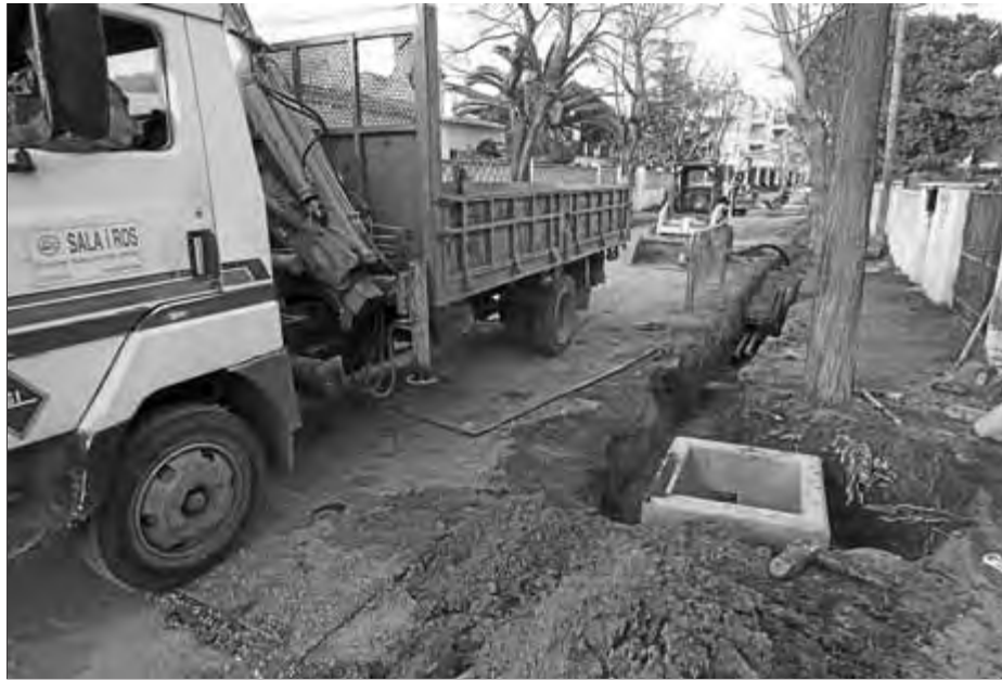
Una imatge de les obres del clavegueram en curs a Empuriabrava ■ MANEL LLADÓ
