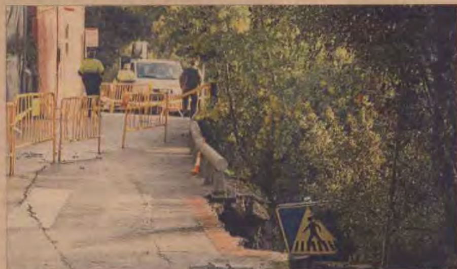
Calçada enfonsada al carrer Lilà a les Planes
