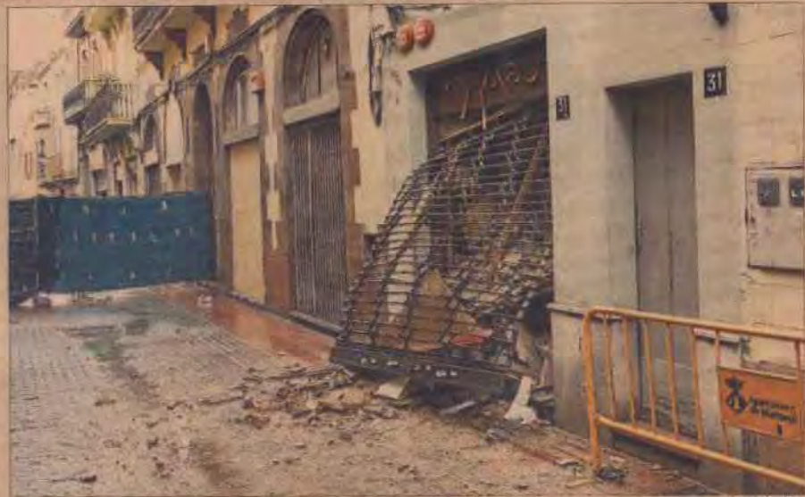
Un habitatge a Martorell va registrar greus desperfectes en enfonsar-se una part de l'estructura
