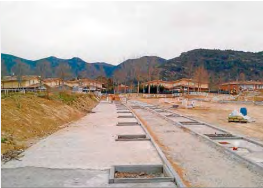
Les obres del nou vial de Roses estaven aturades des del 2011 ■ EL PUNT AVUI
