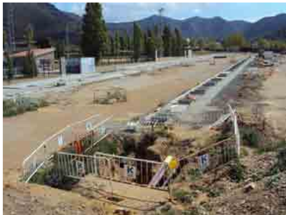
Foto núm. 5 Estat general de les obres del final del vial (excavació del pou de bombament)
