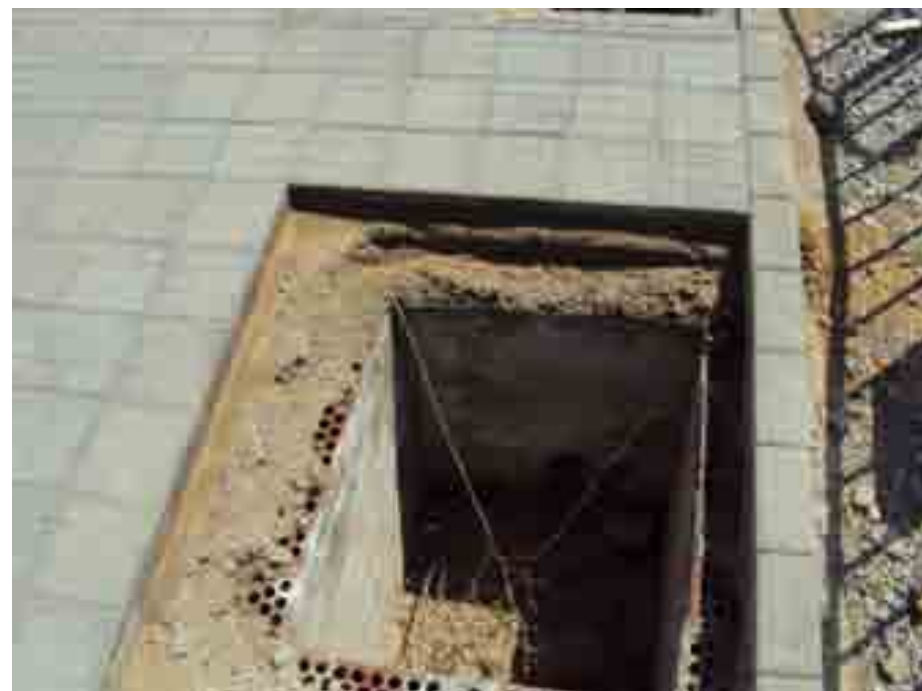
Foto núm. 23 Detall arqueta sense tapa
