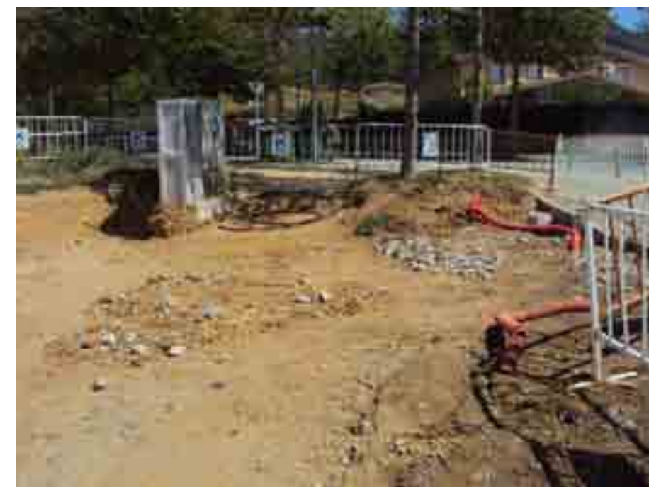
Foto núm. 28 Situació quadres existents
