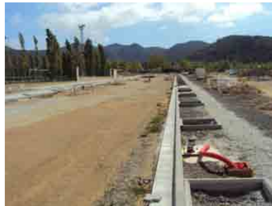
Foto núm.6 Vorera sud
