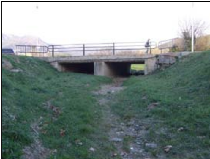
Foto 11. Pont de la ronda de circumval·lació consistent en dos calaixos de 4mx2m..
