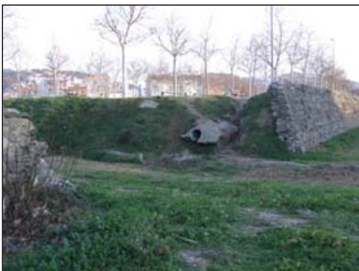
Foto 8. Entrada al fossar amb els desperfectes al marge esquerre i el tub de PVC D315 descalçat.
