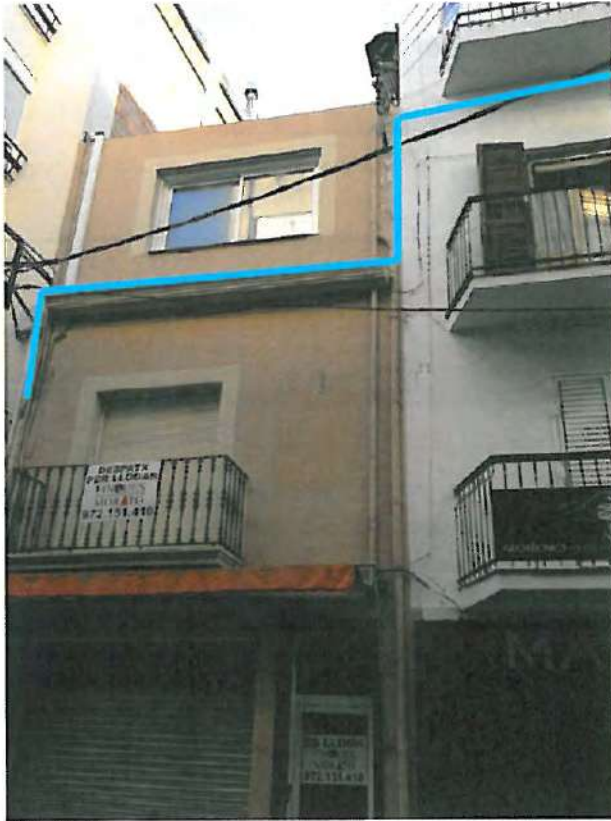
Foto - Detall traçat xarxa B.T. en façana.
