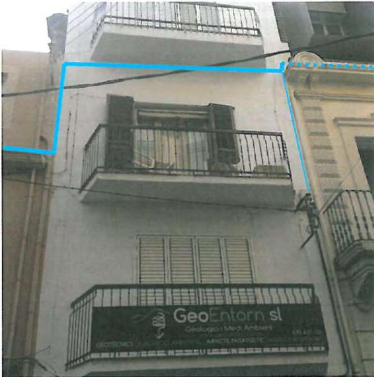
Foto - Detall traçat xarxa B.T. en façana.
