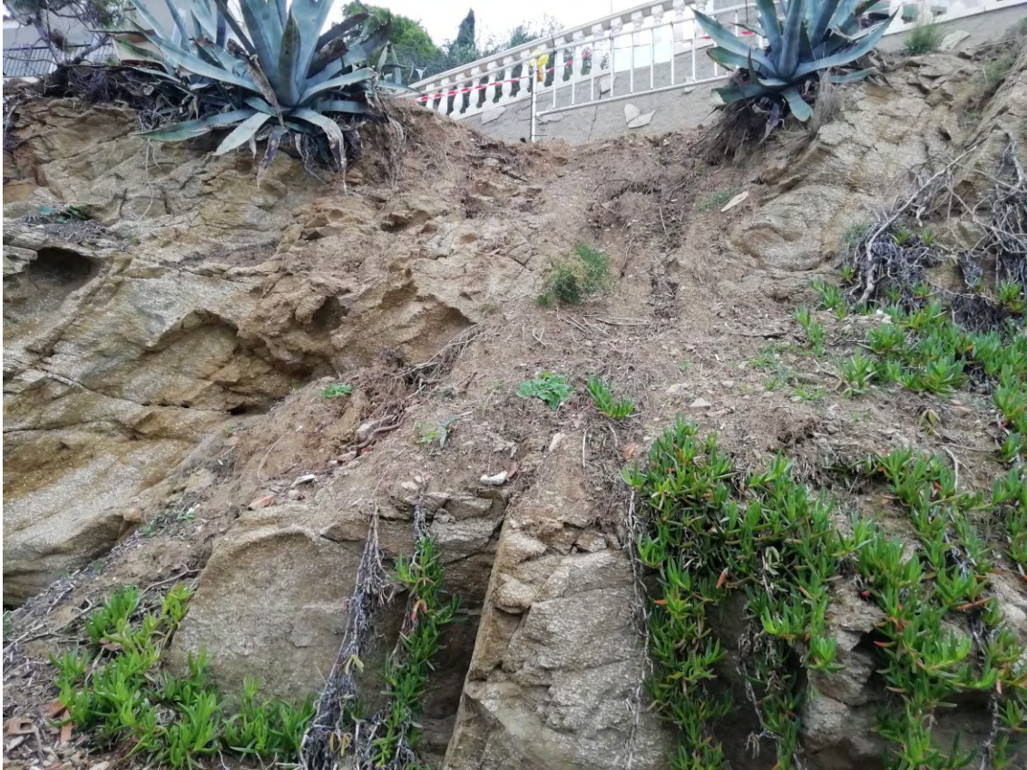
Fotografia 5. Talús amb necessitats d'estabilització
